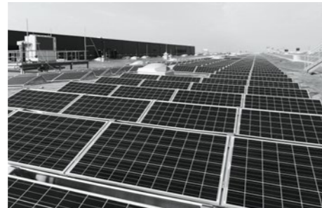
FOTOVOLTAIKANLAGEN IM WERK LEIPZIG
